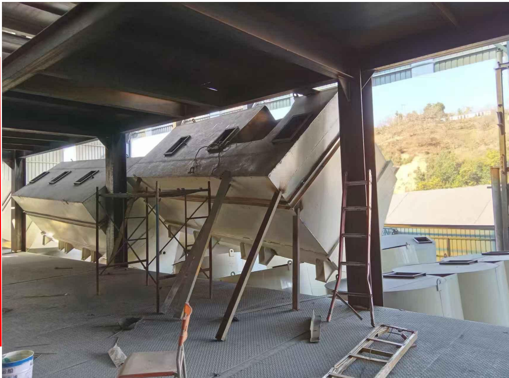
事故现场二层平台概貌
